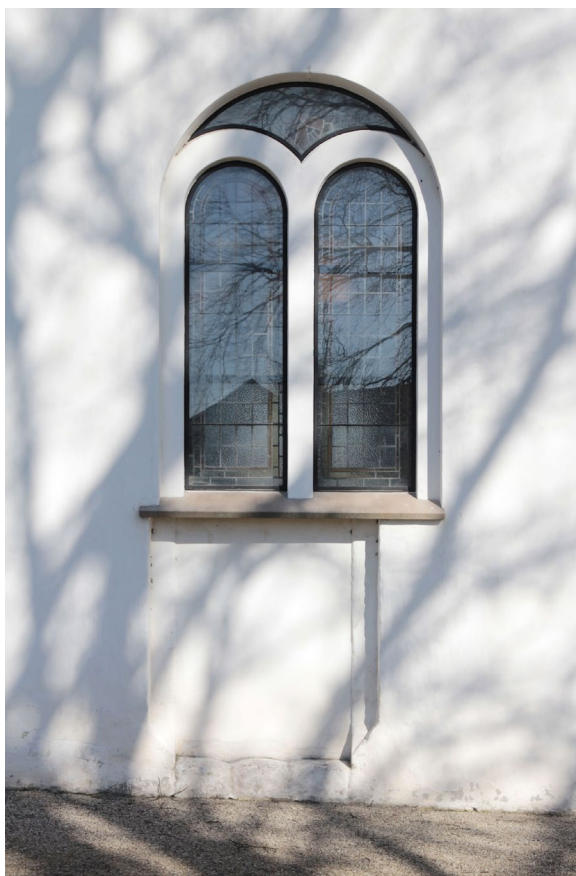
Fönster i södra fasaden. Under fönstret syns spår av den medeltida sydportalen.
